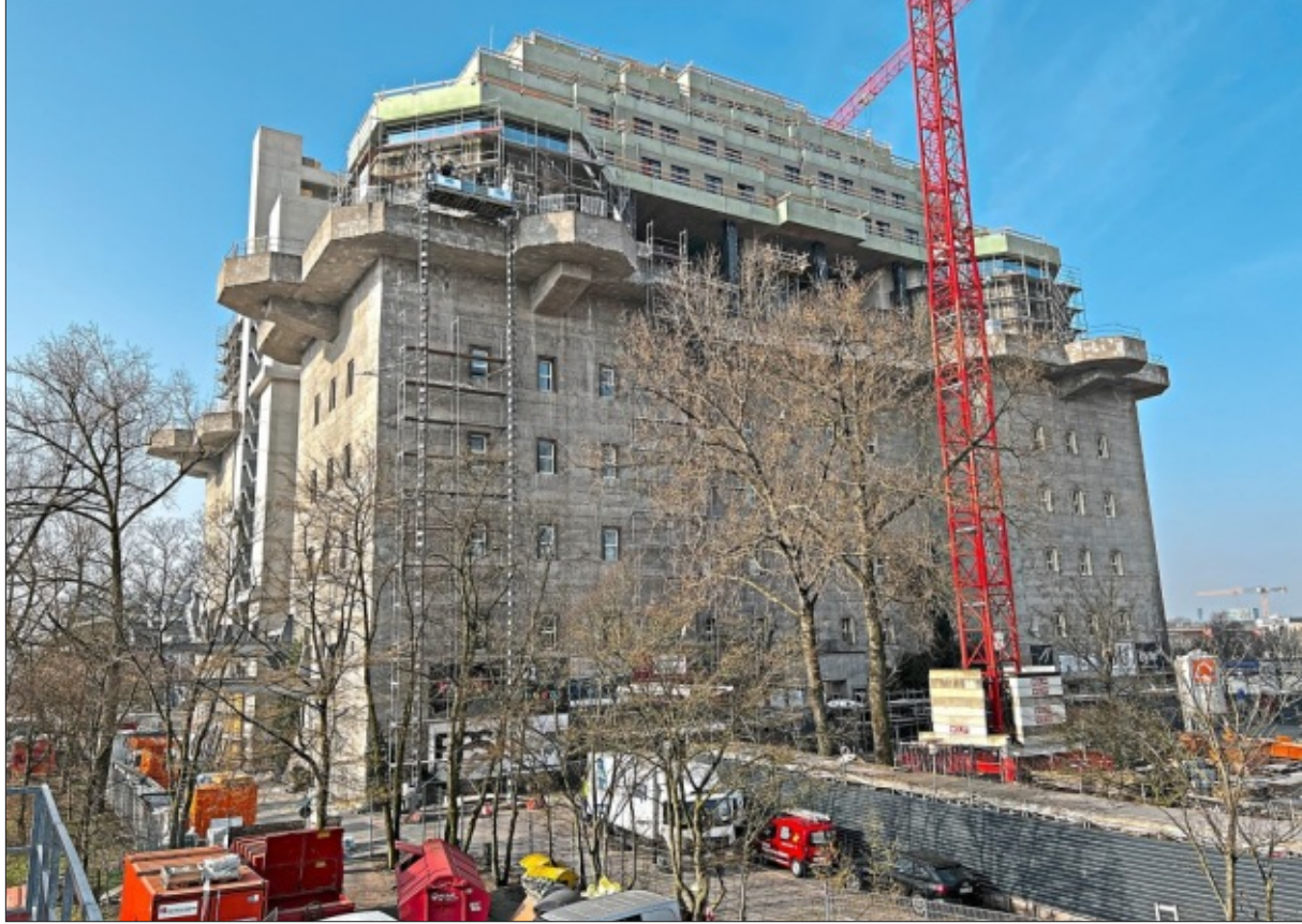
Der denkmalgeschützte Flakturm IV auf dem Hamburger Heiligengeistfeld bekommt einen sechsstöckigen Aufsatz. Das Hotel richtet der niederbayerische Hotelausstatter Bachhuber Contract ein. – Fotos: Reverb/PNP
